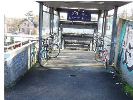
nicht barrierefreier Gleiszugang an der Rheingaubrücke, VB 3
